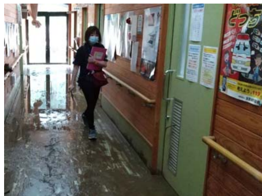
球磨川の氾濫による浸水被害をうけた球磨村診療所を視察（熊本県）
